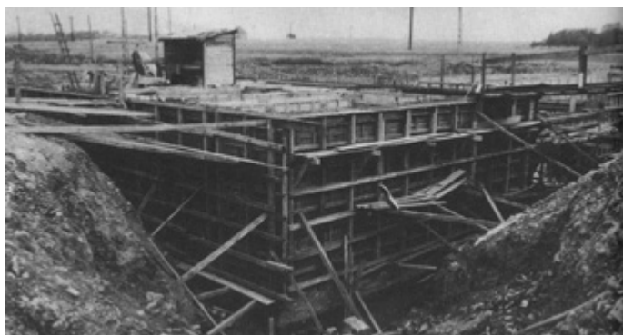
Zakládací poměry – kotelna.
