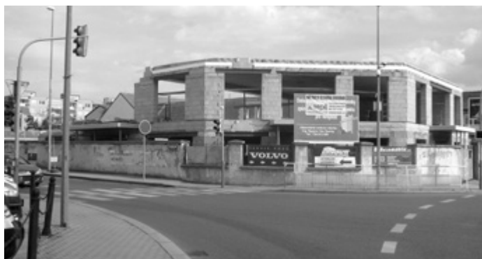
Nově budovaný polyfunkční dům na křižovatce Libušské a Dobronické. Foto: Šárka Pichová
