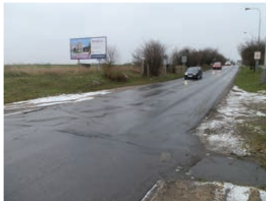
To se ovšem nedá říci o paralelní komunikaci Libušská od Kunratické spojky směrem do staré Písnice, kde brzdou dráhu v klesání směrem k frekventované křižovatce prodlužují četné nerovnosti povrchu vozovky.
