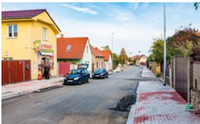
V jižní části Písnice jsou již chodníky po obou stranách komunikace, čeká se na finální vrstvu asfaltu.
