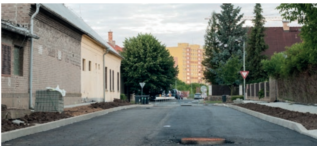
▲ Na Libuši se v současné době chýlí k závěru rekonstrukce ulice Božejovická. Fotoreportáž Kryštofa Štafla okomentoval starosta Libuše a Písnice Jiří Koubek
