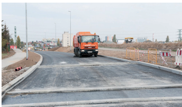
Na čtyřech místech na hlavní silnici v Písnici budou zpomalovací příčné prahy.
